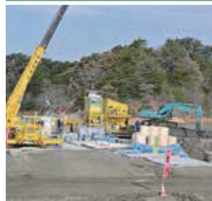
改良プラントによる大量処理
