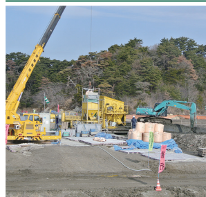
改良プラントによる大量処理
