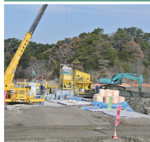
改良プラントによる大量処理
